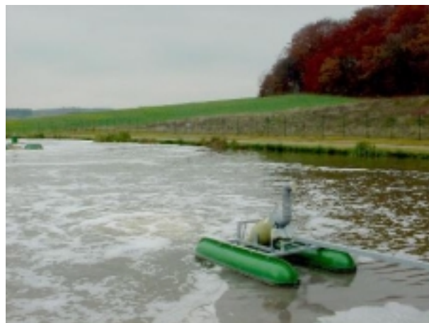
Lagunage aéré de Loupershouse (57) 2500 EH
