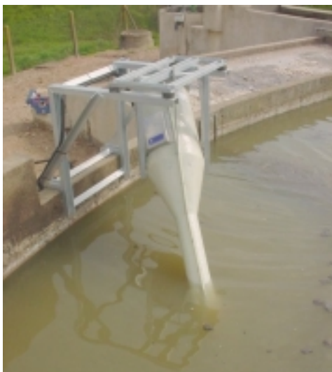
Aérateur monté sur le voile du bassin
